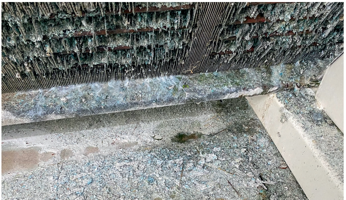
Abbildung 1: Durch Schadgase (WC-Abluft) angefressene Aluminium- Lamellen. Auch die Schutzlackschicht konnte der Schad- gaseinwirkung nicht lange standhalten. Dieses Bauteil musste ersetzt werden.
