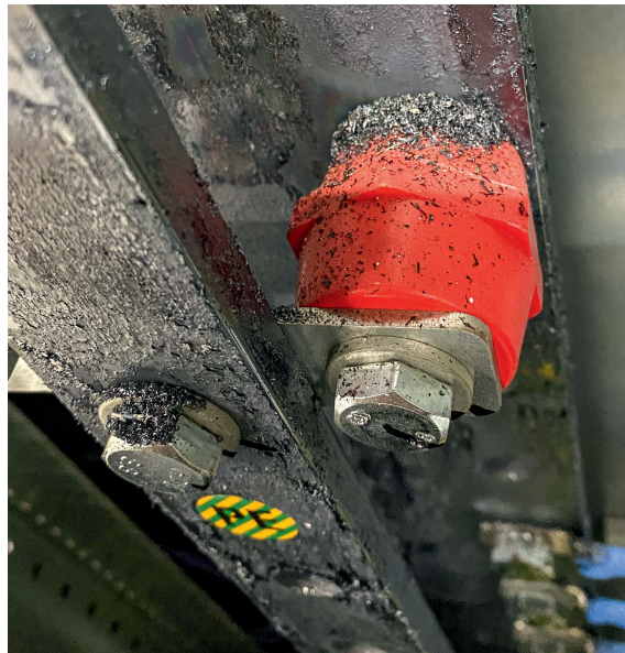
Abbildung 2: Korrosionserscheinung an ehemals roten Kupferleitern. Das Korrosionsprodukt – hier metallisch-gräuliches Kupfersulfid – haftet nicht mehr an der Oberfläche und blättert ab.
